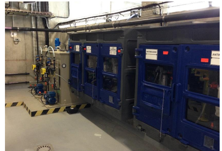
Zone pressurisation / réactifs, avec zone de stockage différenciée
