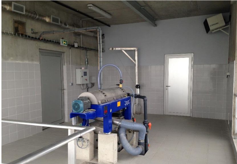
Décanteur centrifuge positionné directement au dessus de la cuve à boues
